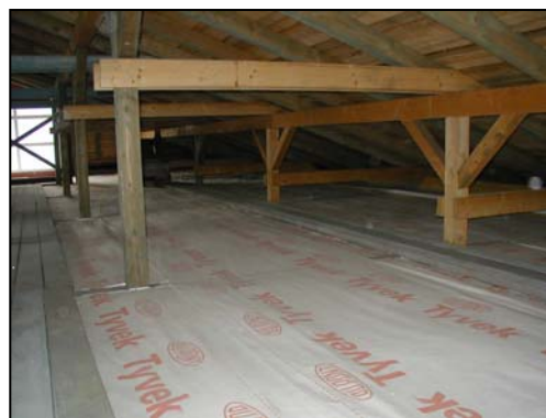
Příklad řešení zateplení pod novou střechou. Izolace Climatizer následně překryta difúzně otevřeným Tyvekem.
